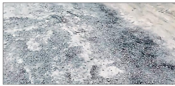
मैंगलगंज से खखरा जाने वाले सड़क की ऐसी हालत है।
