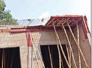
निर्माणाधीन राशन की दुकान की ढही हुई छत।
