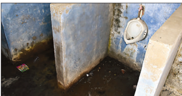
स्कूल का जर्जर शौचालय व टूटी पड़ी यूरिनल की पाइप।
