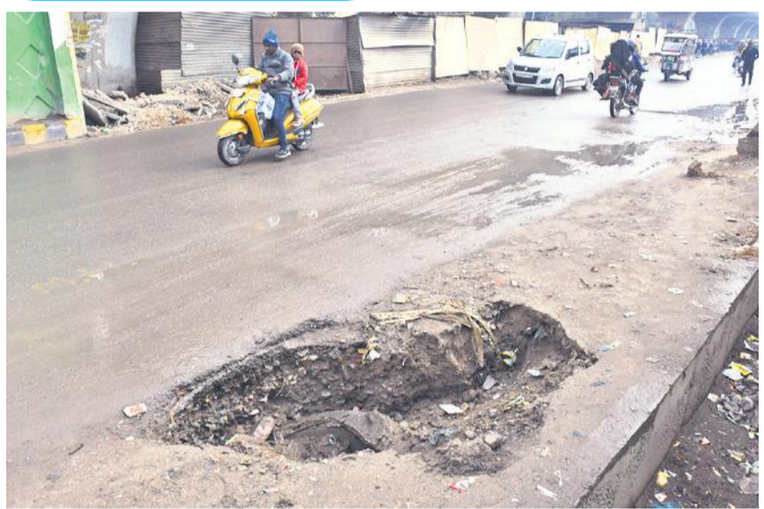
चौपला से सिटी स्टेशन जाने वाले मार्ग के किनारे सड़क धंसने से गहरा गड्ढा हो गया है। इससे हादसे का डर बना हुआ है, लेकिन अफसरों का ध्यान इस ओर नहीं है।
