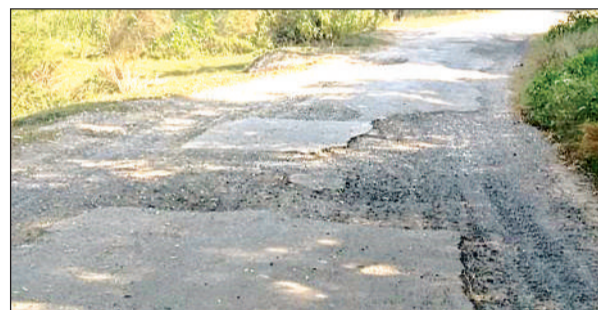
टूटी पड़ी राट रोड से अजनारी मार्ग की सड़क।
