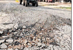
ध्वस्त पड़ी नवीन गल्ला मंडी की सड़क।
