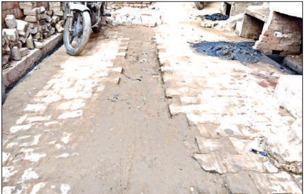
इस तरह पाइप लाइन डालने के बाद खास्ताहाल पड़ी सड़क।
