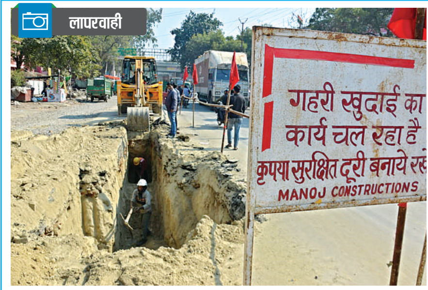
बिना शटरिंग के गहरी सीवर लाइन की खुदाई: प्रोजेक्ट कॉन्ट्रक्टर ने मजदूरों की जान को खतरे में डाला। मजदूरों की जान जोखिम में डाल कर जामऊ चुंगी के निकट बिना शटरिंग व बैरिकेडिंग लगाकर गहरी सीवर लाइन की खुदाई की जा रही है। मिट्टी धंसने का खतरा बना है। शहर में पूर्व में गहरी सीवर लाइन खुदाई में कई मजदूर अपनी जान गवां चुके हैं। इसके बावजूद प्रशासन ने सबक नहीं लिया।
