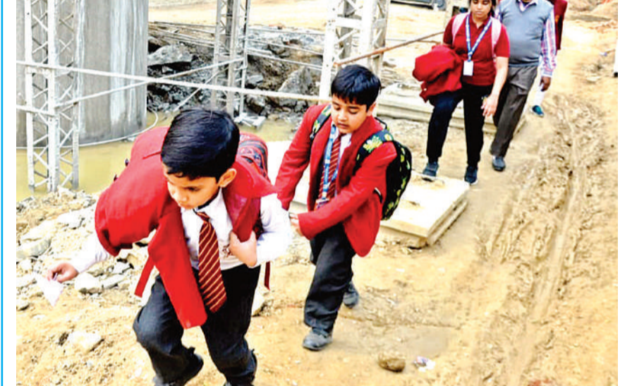
स्कूलों की बच्चों की डगर में खतरा: जयपुरिया रेलवे क्रासिंग पर निर्माणाधीन ओवरब्रिज के निर्माण में सेतु निगम की लापरवाही से स्कूलों की बच्चों की जान जोखिम में है। बिना बैरि कैडिंग के खुदे पड़े पिलर के गहरे गड्डे के बगल से बच्चे गुजरते हैं। अक्सर वे मस्ती भी करते हैं। ऐसे में डर लगता है कि कहीं वे गिर न जाएं।
