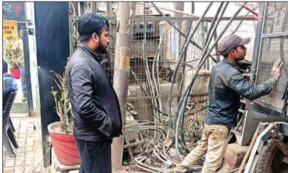
नाली फटने से धंसा ट्रांसफार्मर।
