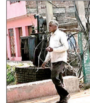
खुले में रखा ट्रांसफार्मर।
