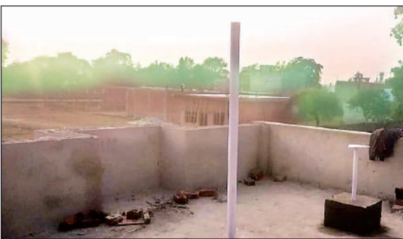
ग्राम पंचायत मथुरानगर के भवन की छत पर लग रहा एआरजी। अमृत विचार
