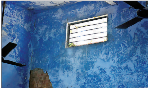
स्कूल भवन के अंदर दीवार का टूट रहा प्लास्टर और खुली खिड़की।
