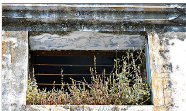
मिशान स्कूल के भवन की खिड़कियों में उगी बड़ी घास।
