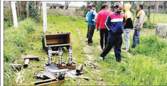
खेत में पड़ा ट्रांसफार्मर और एकत्र ग्रामीण।
