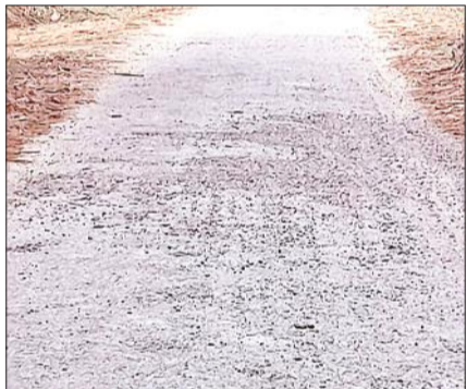
जर्जर कपरहा बांसगांव संपर्क रोड।
