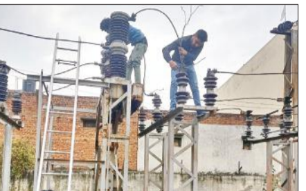
अजीतापुर बिजलीघर में रखे ट्रांसफार्मर में काम करते कर्मचारी।
