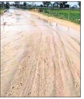
डंपरों के चलने से जर्जर हुई सड़क।
