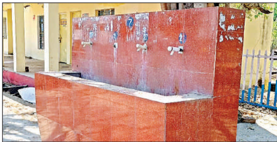
रेलवे स्टेशन की सूखी पड़ी नल की टोटी।
