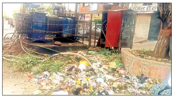
स्टेशन रोड जीजीआईसी कॉलेज के पास कचरे के ढेर के पास लगा ट्रांसफार्मर।
