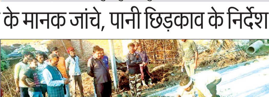
निर्माणाधीन सड़क पर गेज डलवा कर मोटाई देखते लोक निर्माण विभाग अधिकारी।
