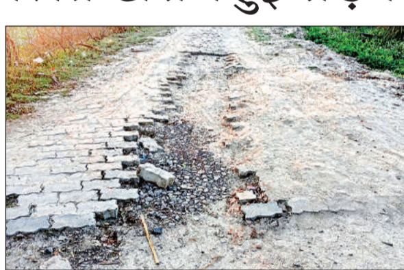
पाइप लाइन डालने के बाद खुदी एवं धंसी पड़ी इंटरलॉकिंग सड़क।
