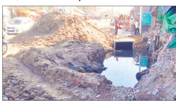
बरखेड़ा में घरों के आगे खोदकर छोड़ा गया नाला।
