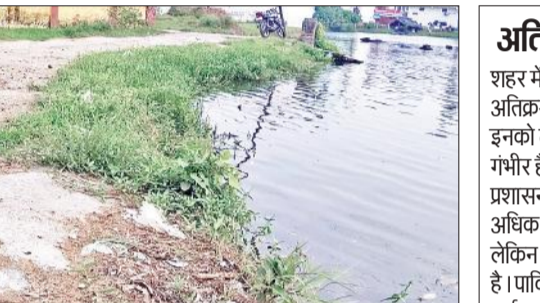
शहर की अवध नगर कॉलोनी में टूटी पड़ी सड़क।
