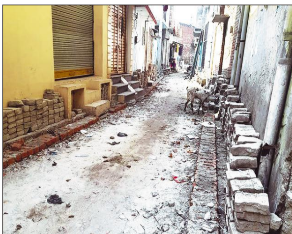
मोहल्ला कोट में मानक विहीन बनाई जा सड़क का रोका गया निर्माण कार्य।
