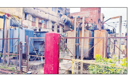
चौक स्थित उपकेंद्र में लगा जर्जर ट्रांसफार्मर।
