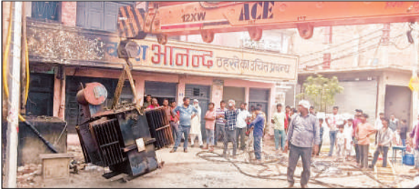
क्रेन से फुंका ट्रांसफार्मर हटाते बिजलीकर्मों।
