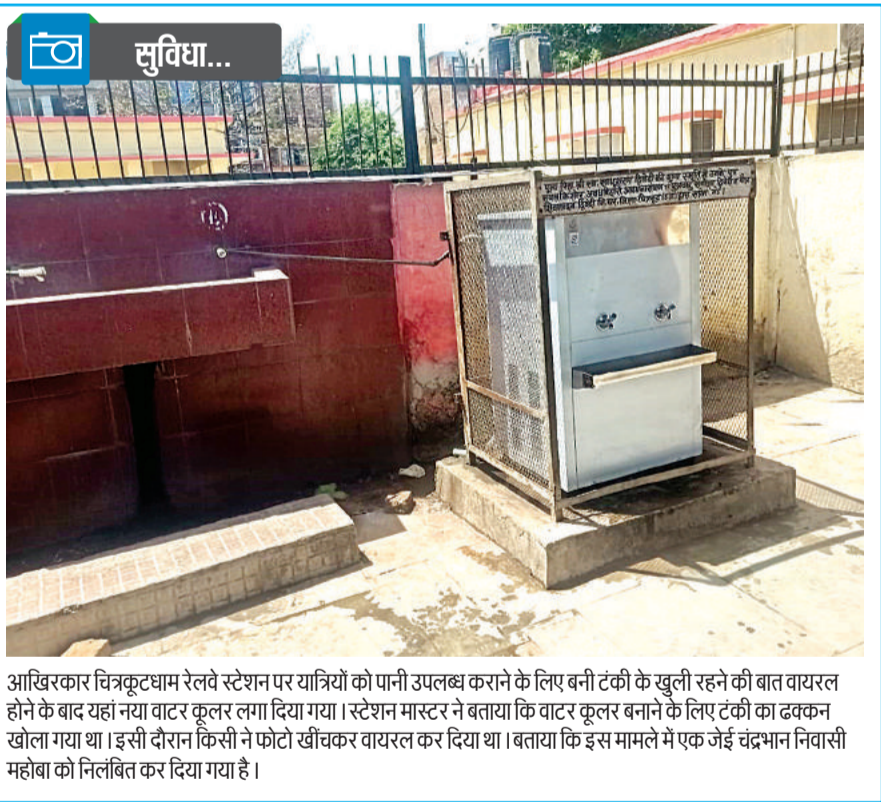
आखिरकार चित्रकूटधाम रेलवे स्टेशन पर यात्रियों को पानी उपलब्ध कराने के लिए पंटी की के खुली रहने की बात वायरल होने के बाद यहां नया वाटर कूलर लगा दिया गया। स्टेशन मास्टर ने बताया कि वाटर कूलर बनाने के लिए पंटी का ढक्कन खोला गया था। इसी दौरान किसी ने फोटो खींचकर वायरल कर दिया था। बताया कि इस मामले में एक जेई चंद्रभानु निवासी महाबा को निलंबित कर दिया गया है।
