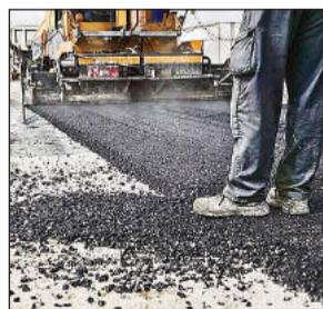
● सड़क निर्माण के चलते पेयजल पाइप लाइन ध्वस्त
