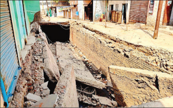
नाले की स्लैब टूट कर गिर गई।
