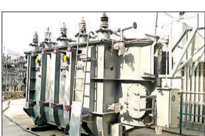
मकरंदनगर ट्रांसमिशन सब स्टेशन में रखा 60 एमवीए का ट्रांसफार्मर।
