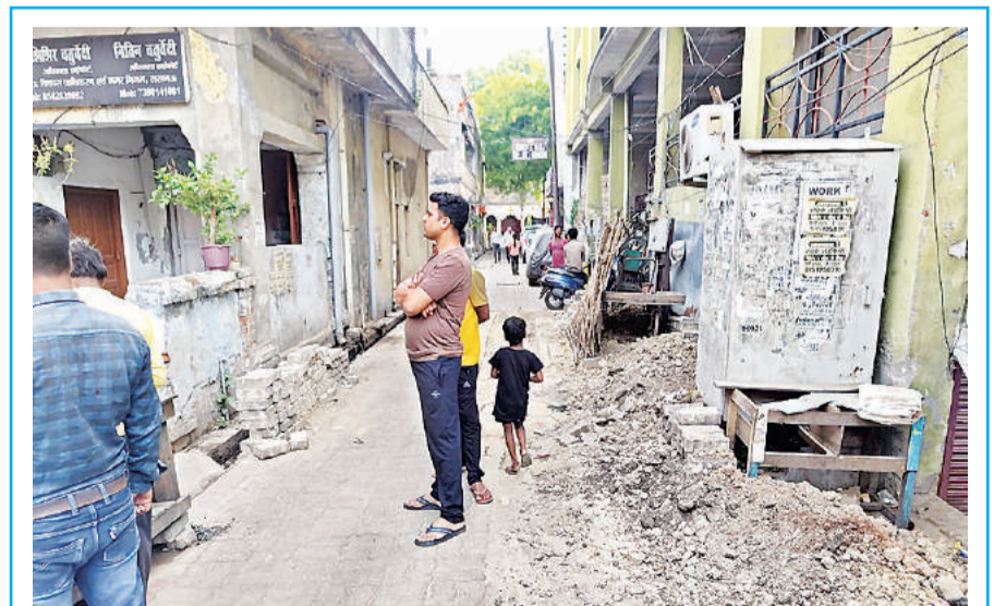
वारबाग सक्की माण्डि स्थित आर. के. इन. होटल वाली गली में सड़क खोदकर नई सीवर लाइन डाली गई थी। इसके बाद मिट्टी नहीं हटाई गई। आवागमन में दिक्कत हो रही है।
