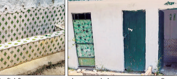
पेयजल के लिए उखड़ी पड़ी टोटी।
