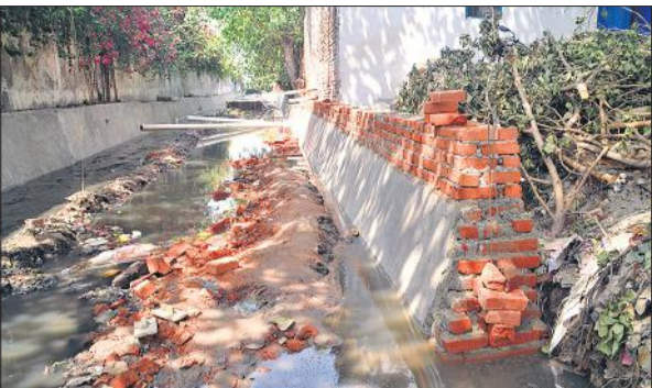
मोहल्ला तुलाराम बजरिया में बन रहे नाले में लगाई जा रही घटिया सामग्री।
