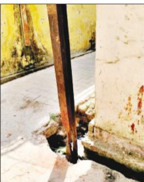
लाइन पार प्रेम नगर गली नंबर दो में जर्जर हालत में खड़ा बिजली का खंभा।
