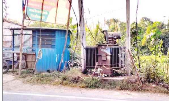
सड़क किनारे खुले में जमीन पर रखा ट्रांसफार्मर।
