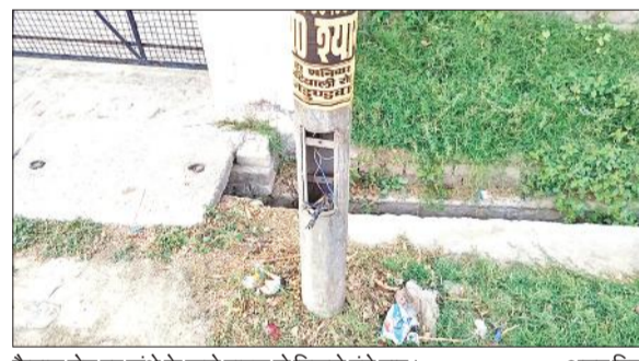
कैनाल रोड पर खंभे के खुले बाक्स से निकले नंगे तार।
