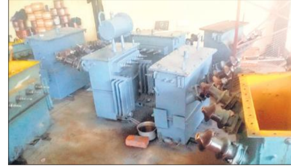
कार्यशाला में मरम्मत करके रखे गए ट्रांसफार्मर।
