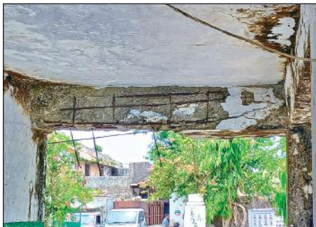
विद्यालय के जर्जर भवन की छत का सीमेंट उखड़ा हुआ।
