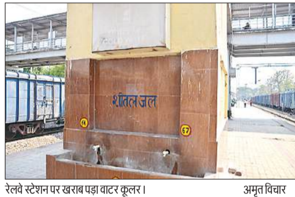
रेलवे स्टेशन पर खराब पड़ा वाटर कूलर।
