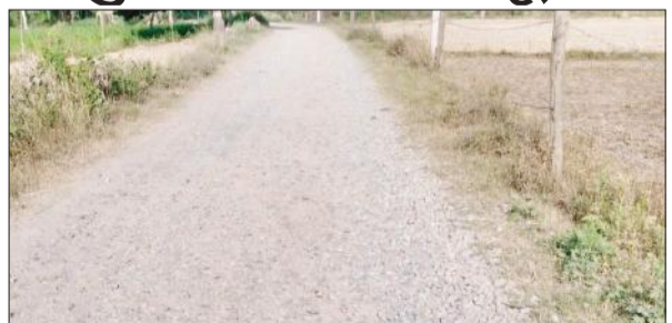
कुदफतेहगढ़ के बेहटा खास के संपर्क मार्ग की उखड़ी सड़क।
