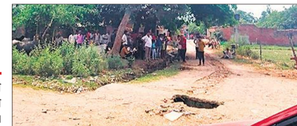
गांव की जर्जर सड़क और टूटी पुलिया।
