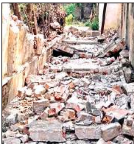
ब्लाक के आवासीय भवन की ढही दीवार
