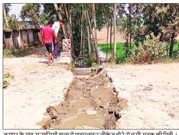
जसपुर के गांव सन्यासियों वाला में पाइपलाइन लीकेज होने से धंसी सड़क की मिट्टी।
