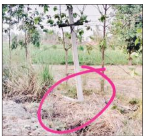
एचटी लाइन का क्षतिग्रस्त खंभा।
