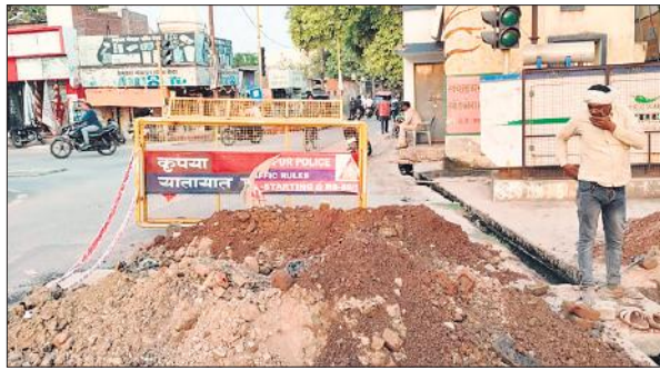
सीवर लाइन डालने के लिए खोदाई कर नगर निगम के पास सोमवार को मिट्टी कुछ इस तरह सड़क पर जमा की गई। जिससे लोगों को परेशानी हुई। ● अमृत विचार
