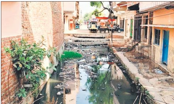
एमनजई जलालनगर के नाले में गंदगी से रुका पानी।
