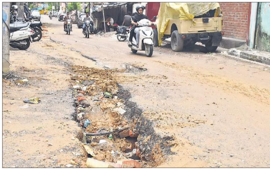
स्टेशन रोड से चौबेवाली गली में सीवर लाइन की खोदाई के बाद छोड़ दिया गया गड्ढा।
