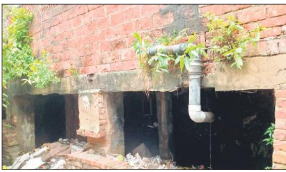
नाले के ऊपर अवैध निर्माण की वजह से नहीं हो पा रही है सफाई।
