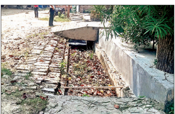
शहर में खुला पड़ा नाला।
