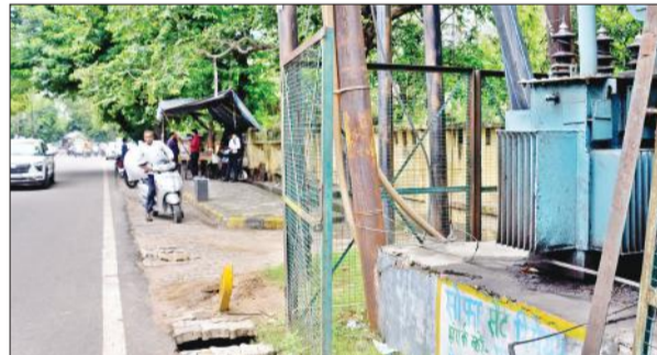
सिविल लाईंस क्षेत्र में खुले में रखे ट्रांसफार्मर की टूटी जाली।
