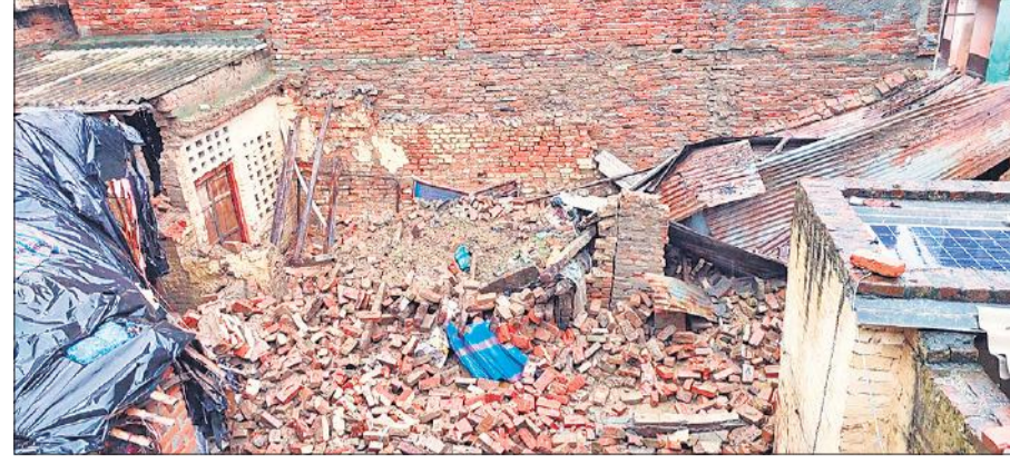
मोहल्ला सरोजनीनगर में पड़ा मकान का मलबा।
