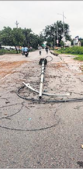
बीडीआर भट्टे के पास सड़क पर गिरा बिजली का खंभा।
