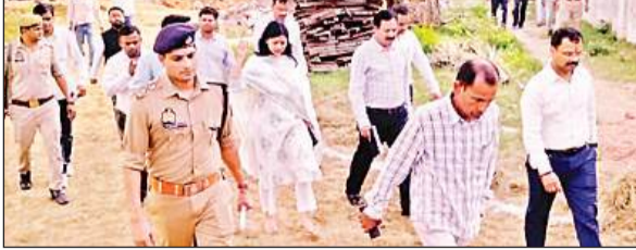
पुलिस लाइन में निर्माणाधीन भवन का निरीक्षण करते नोडल अधिकारी एल. वेंकटेश्वर लू।
